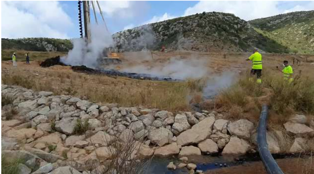
Surgència de “quitrà” (elevada pressió interna)
